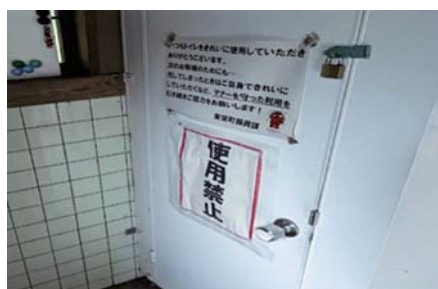
町内の公衆手洗い (故障中)
