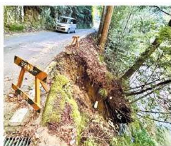
崩落した町道（柿野地内）
